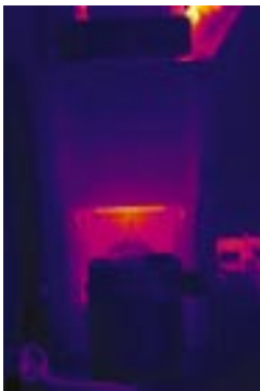
Θερμογράφημα καλά μονωμένου λέβητα μονοκατοικίας. Παρατηρείστε την θερμή περιοχή (κόκκινο χρώμα) στην πόρτα του θαλάμου καύσης.
